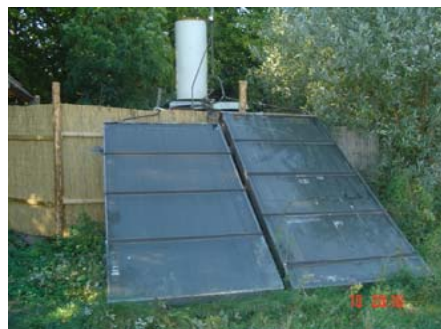
на фото: солнечные коллекторы нагревают воду для душевой в Эко Дорфе
