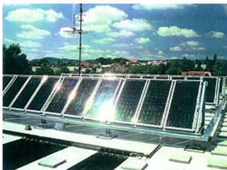
на фото: солнечные коллекторы на крыше дома в Венгрии
