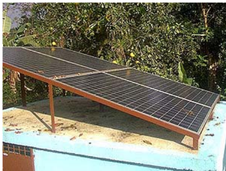
на фото: пример использования солнечных коллекторов на Ямайке
