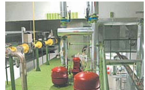
на фото: в зале биогазовой станции на свалке Пааскула в Таллинне
